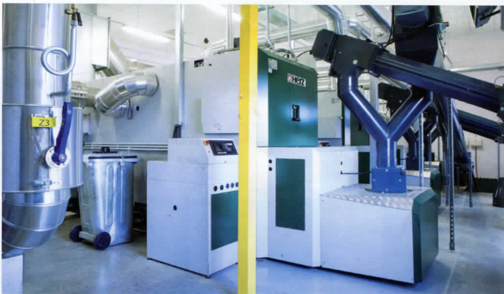
► W kotłowni w Złoczewie działa m.in. kocioł HERZ o mocy 1 MW
